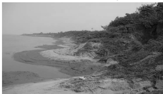
Ảnh 2. Bờ xói lở tạo vách và cắt xẻ mạnh (Đoạn bờ không kè đá học tại xã Hợp Thịnh và Hợp Thành, tỉnh Hòa Bình).
