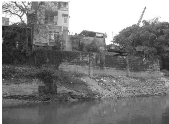
Ảnh 6. Ngôi nhà xây trên nền đá gốc tại bờ phải sông Đà bị nứt và sứt (tại phía Bắc phường Đồng Tiến, Tp. Hòa Bình).
