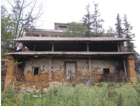
(a) Nhà trình tường trên 100 năm tuổi của dòng họ Vương tại thôn Chúng Pá A đã bị xuống cấp mạnh (Ảnh Đặng Văn Luyến., 2013).
