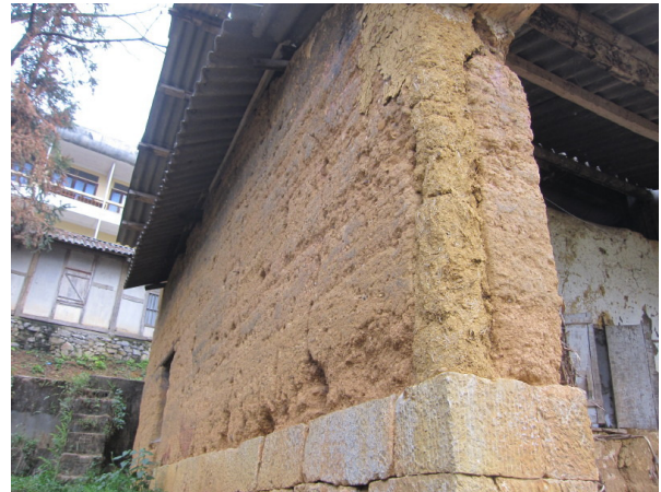
(b) Bức tường đầu hồi nhà bị hư hại nặng nhưng chỉ mới được sửa chữa nhỏ (Ảnh Đặng Văn Luyến., 2013).
