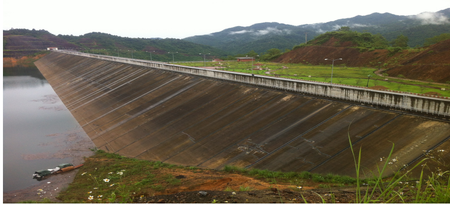
Hình 5. Hiện trạng đập bê tông bản mặt Cửa Đạt Thanh Hóa.
