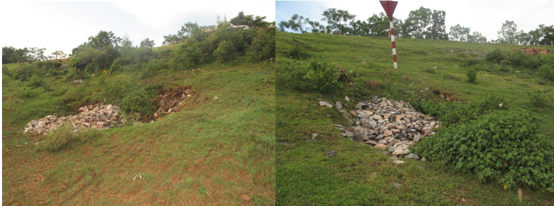
Hình 2. Hố sụt do thấm qua nền đê.
