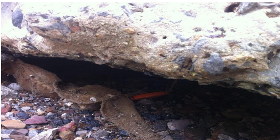
Hình 7. “Thoát không” dưới lớp bê tông do sóng đánh.
