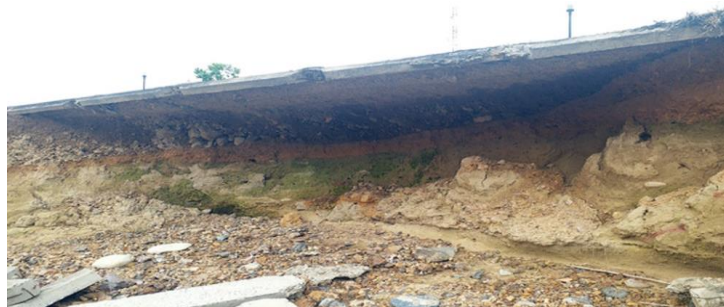
Hình 5. “Thoát không” dưới lớp bê tông do xói chân bê tông
