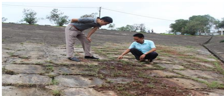
Hình 6. “Thoát không” dưới lớp bê tông do xói thấm qua thân đập.
